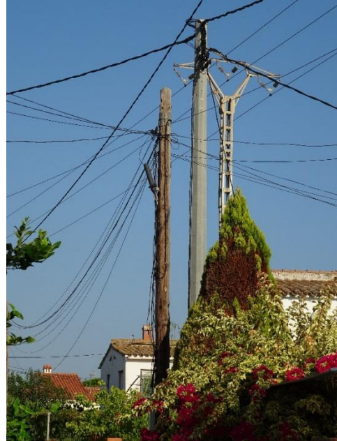
Imagen del estado actual del cableado. Fuente: elaboración propia
